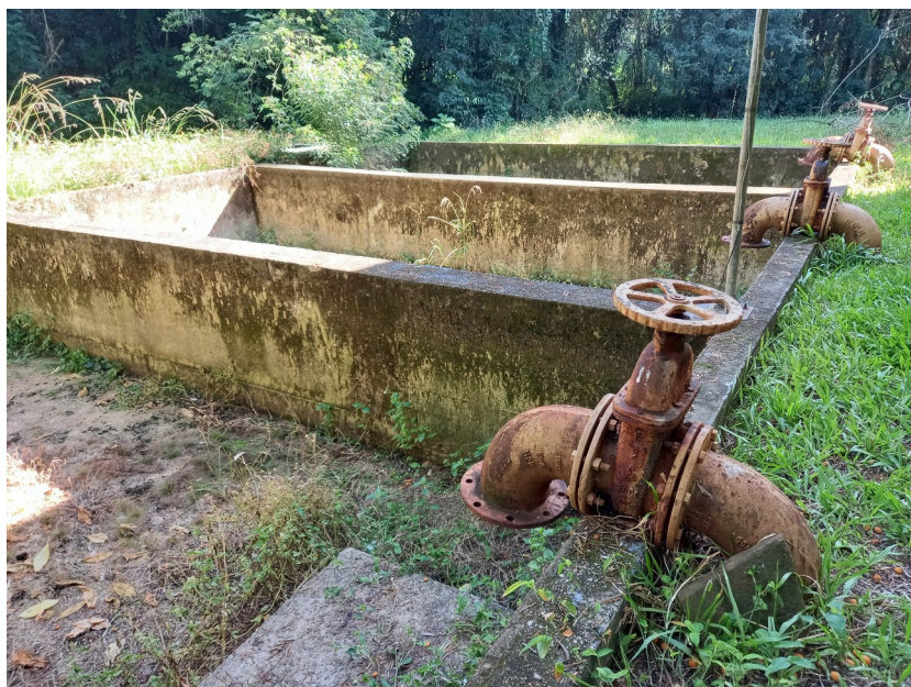
Figura 9: Leitos de Secagem
