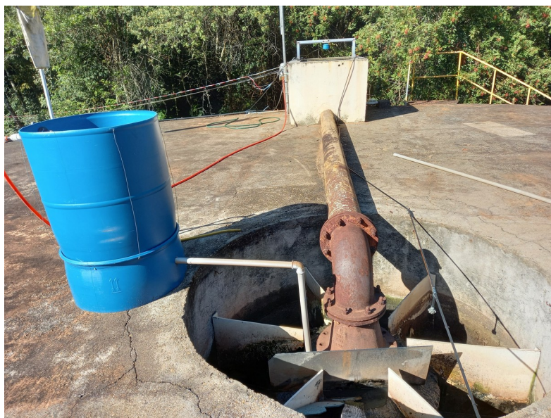
Figura 6: Entrada do Efluente no Reator Anaeróbico
