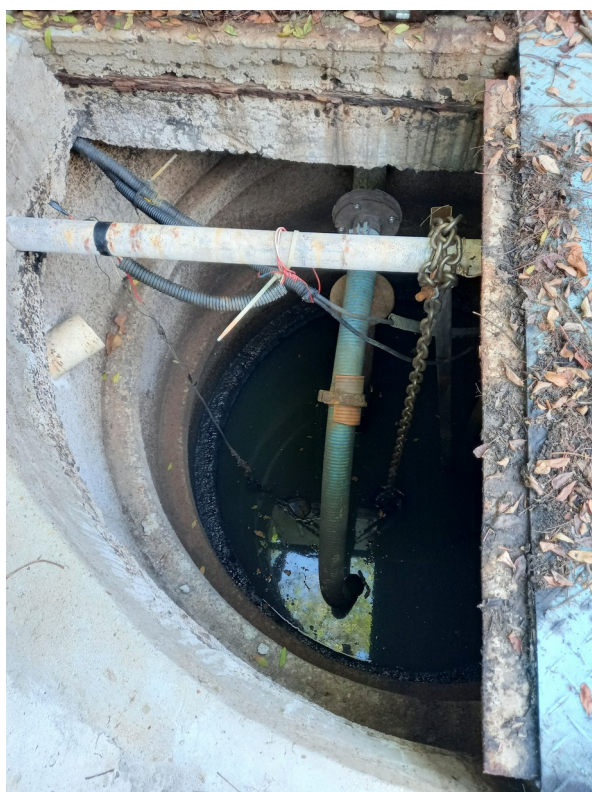
Figura 3: Chegada de esgoto bruto na ETE
