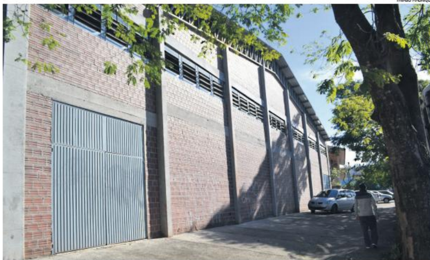
Iniciada em 2010, construção foi paralisada três anos depois. Hoje, prédio é alvo de vandalismo e pichações
