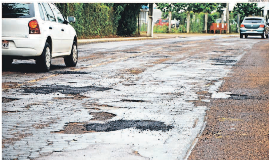
Rua Bento Rosa, entre o Hidráulica e Carneiros, recebeu asfalto novo. Ainda assim, há desníveis em vários pontos
