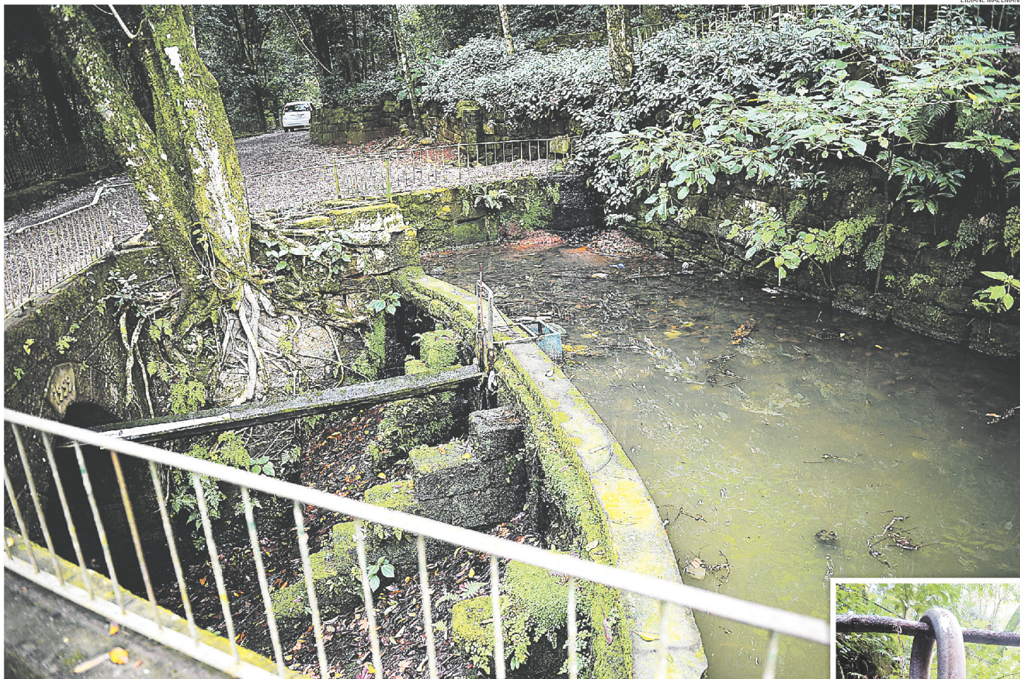
Falta de manutenção no Parque do Engenho causa perigos aos visitantes. Sem previsão de melhorias, local fica a mercê de usuários de drogas
