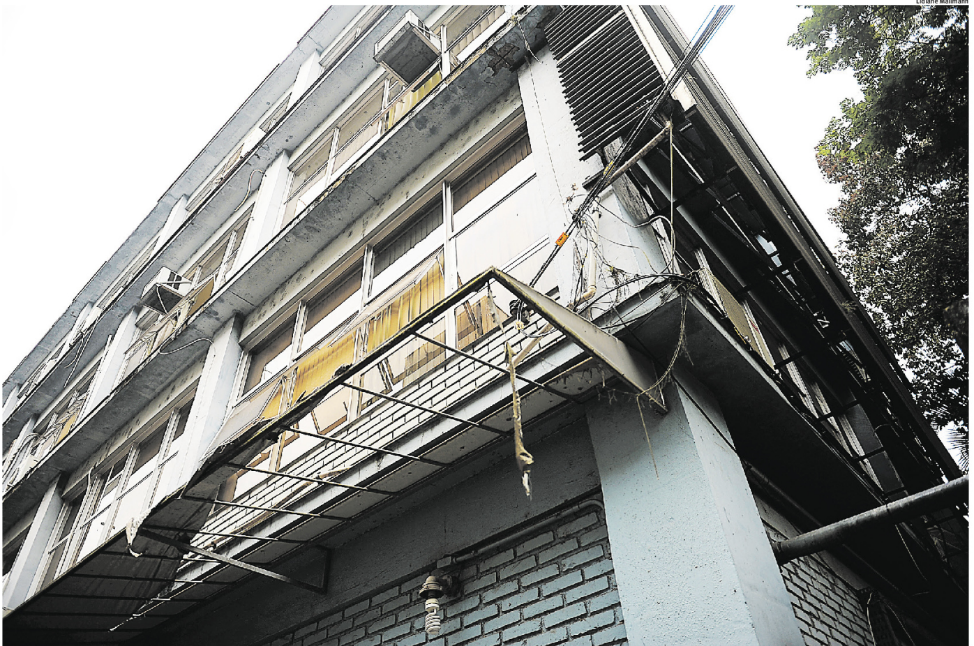
LAJEADO: sem reformas desde 1982, os reparos nos 3,9 mil metros quadrados na estrutura da Administração Municipal devem ocorrer ainda este ano
