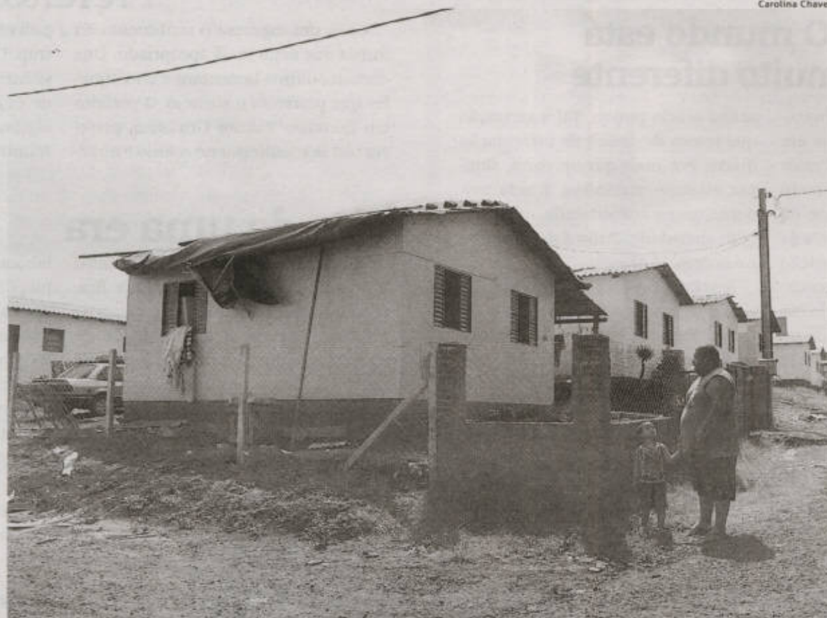
Casa do motorista Jacir Rodrigues da Cunha ficou 40% destelhada
