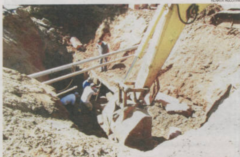
Buraco aberto faz uma semana tem cerca de cinco metros de profundidade
