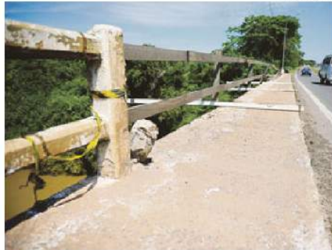
ESTRUTURA: ponte sobre o Arroio Boa Vista, na BR 386, está danificada há sete meses
