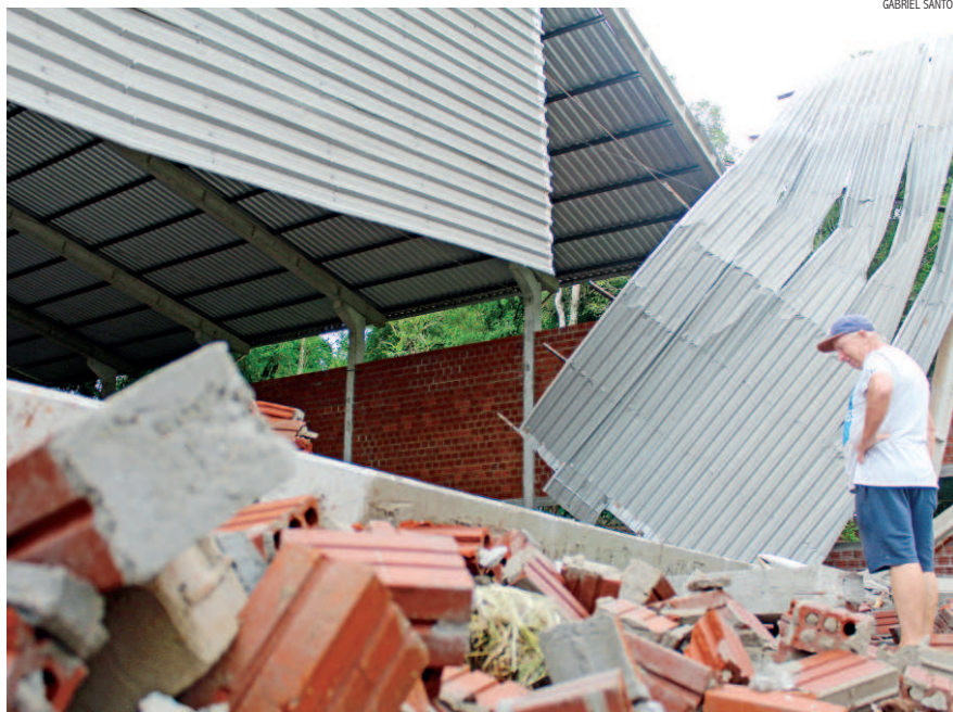
Obra de reforma do espaço não estava pronta e foi danificada com os ventos na madrugada de ontem
