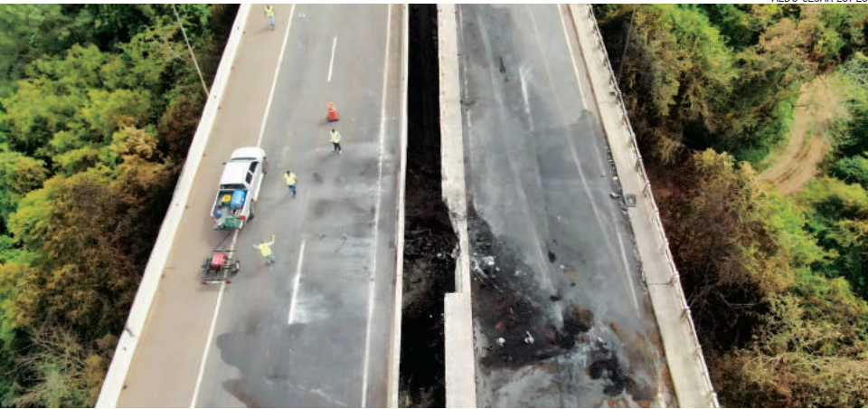
Explosão de caminhão-tanque em 13 de março comprometeu ponte sobre Arroio Boa Vista
