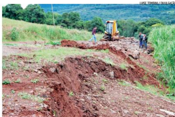
Chuva danificou estradas. Em Boqueirão, município decretou emergência
