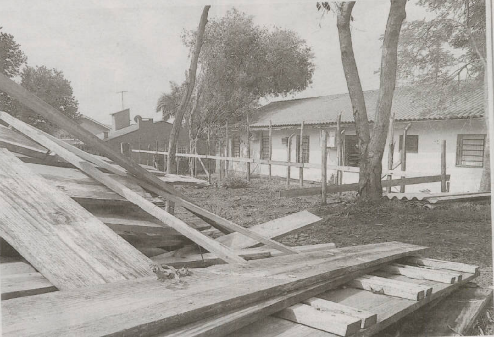
Até a tarde de ontem, a obra do novo prédio da UBS do Bairro Conventos estava parada
