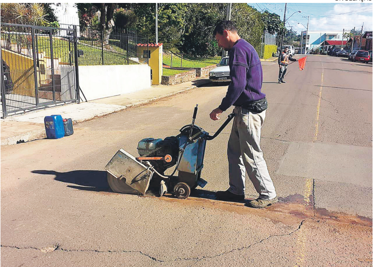
Corte no asfalto da Avenida Frederico Haenssger
