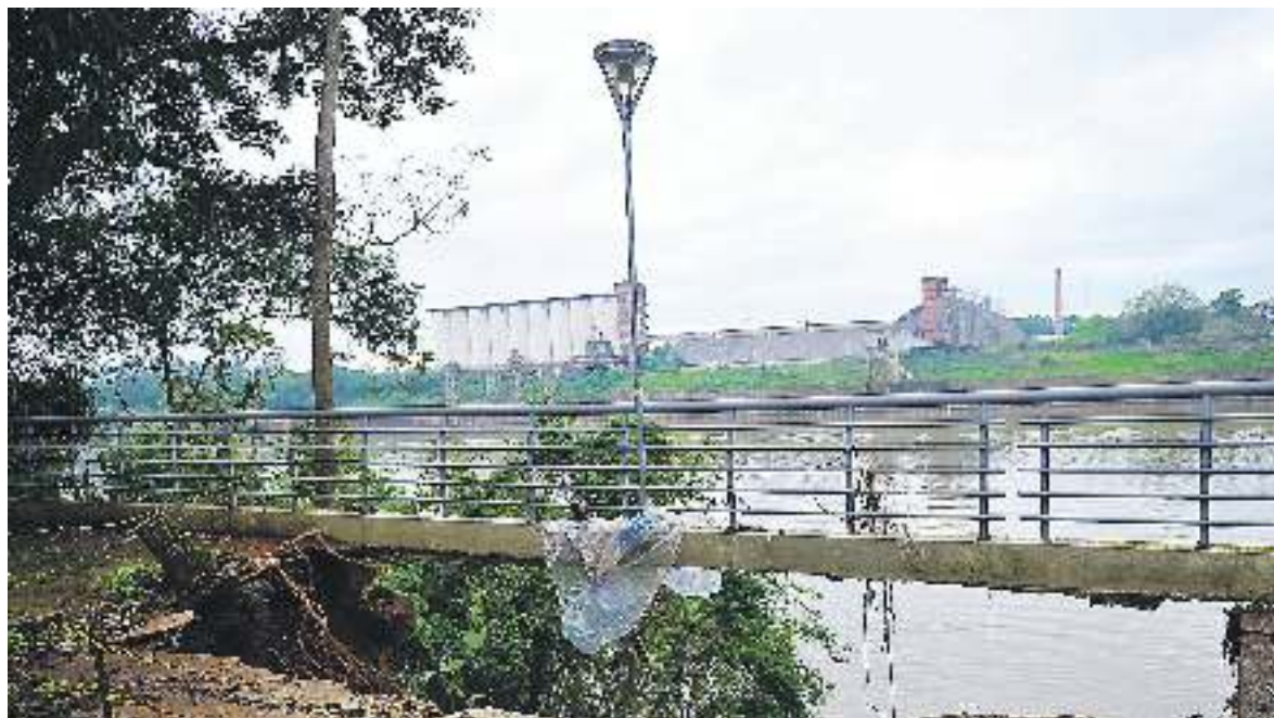
Em Lajeado, na Rua Osvaldo Aranha, parte de um dos belvederes cedeu devido às cheias de julho
