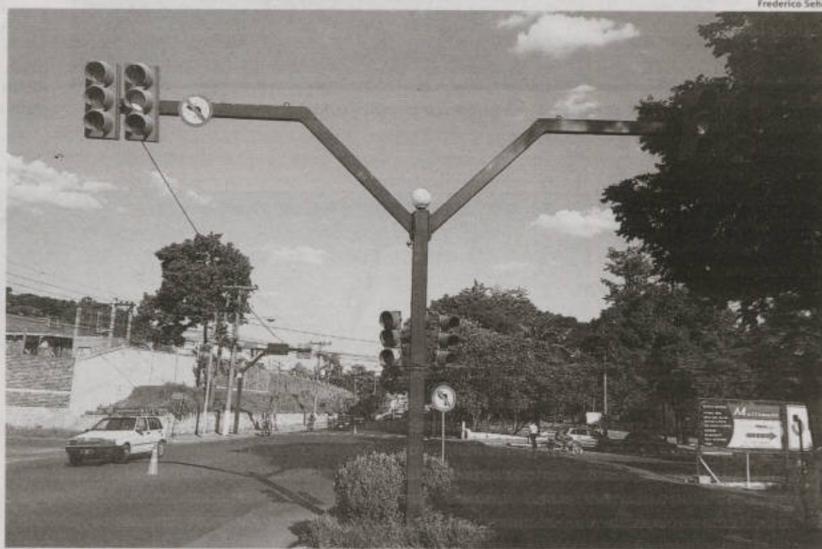
Reposição de controlador deve solucionar problema em semáforo próximo à Rodoviária
