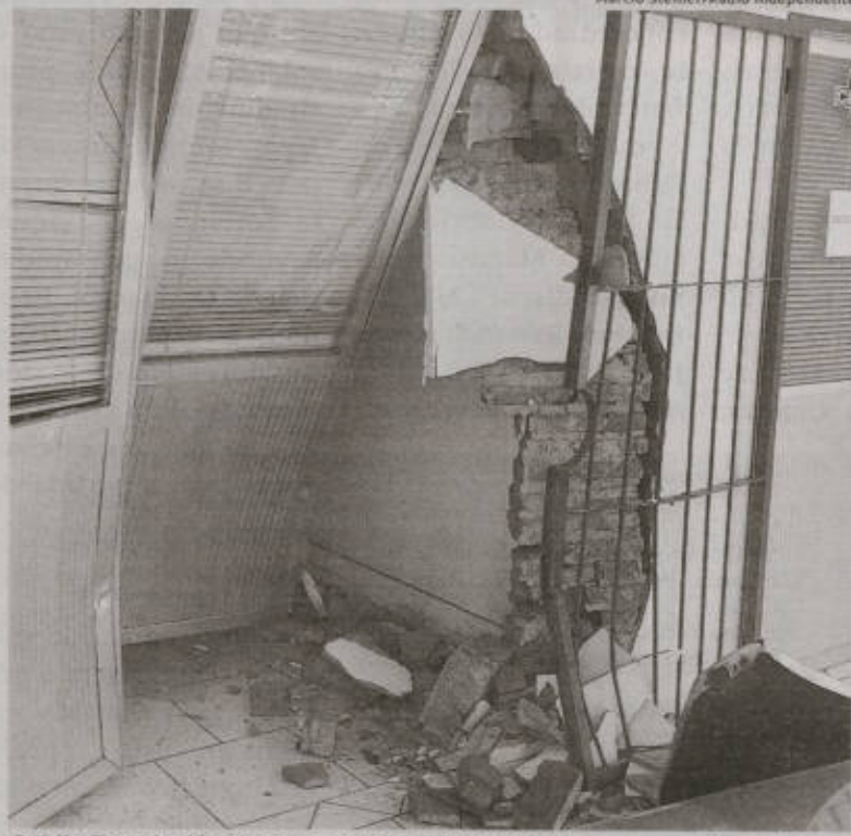
Prédio ficou danificado com a colisão do automóvel
