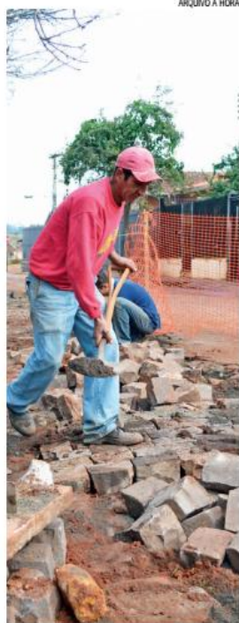
REDE DE ESGOTO: Menos de 1% das casas de Lajeado tem ligação com a Estação de Tratamento de Esgoto do bairro Moínhos
